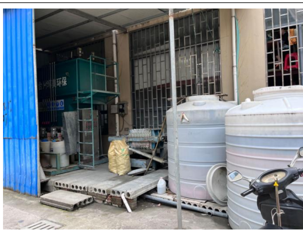
废水处理设施
